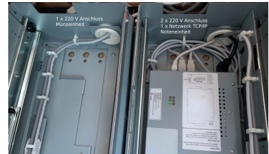
CI-10, Kabelanschluss am Automaten
